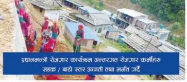
प्रधानमन्त्री रोजगार कार्यक्रम अन्तर्गत रोजगार कर्मीहरू सडक / बाटो स्तर उन्नती तथा नर्मत गर्दै
